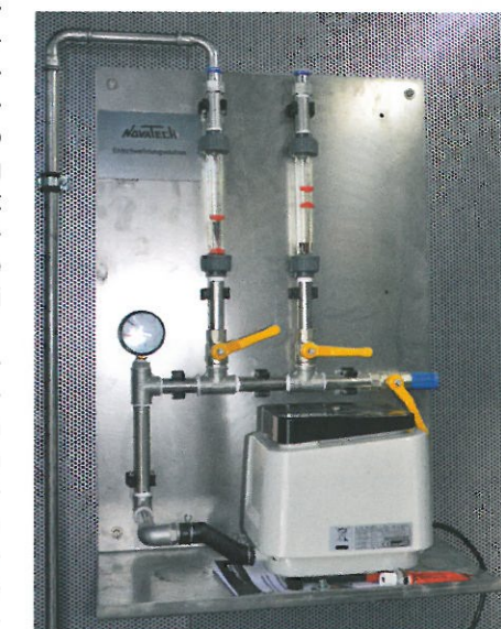
Hier wird die Luft für die biologische Entschwefelung zudosiert.
