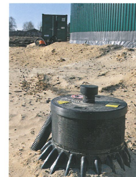
In der unterirdisch verlegten Gasstrecke kondensiert das Wasser aus.
